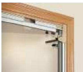
Colocación de los tapajuntas utilizando como guía los topes dispuestos al efecto.
